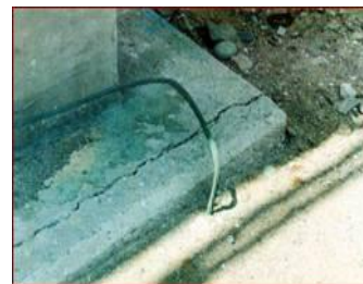
Cimentación deteriorada por la agresión de sulfatos.
