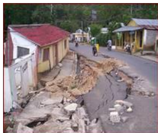
Grietas sobre el asfalto asociadas a la existencia en el suelo de arcillas expansivas
